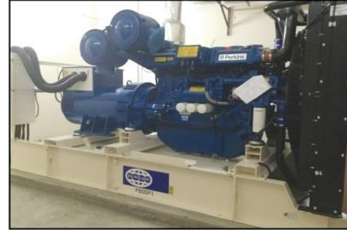
Perkins 800KVA Generator
